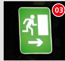
Signalisation der Fluchtwege
