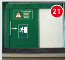
Fluchtwegtüre elektrisch überwacht
